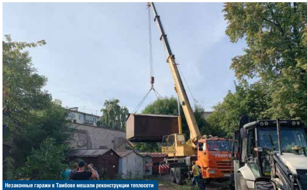
Незаконные гаражи в Тамбове мешали реконструкции теплосети
